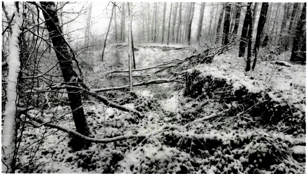
Северо-западный борт оползня, стенка отрыва. Вид от головы оползня вдоль борта.
